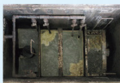
稼働中のグリーストラップ
